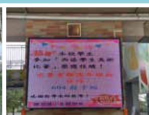
▲新設LED電子看板
